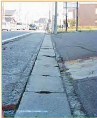
① 既設側溝の危険状況
