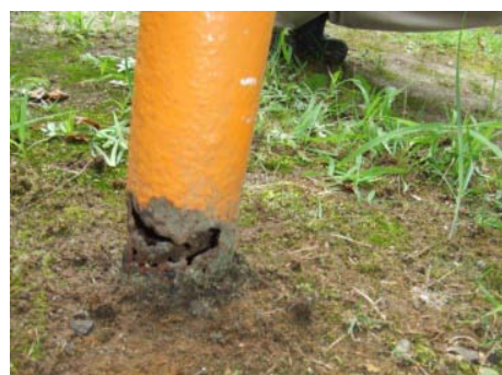
写真4 鉄棒2 腐食部分
