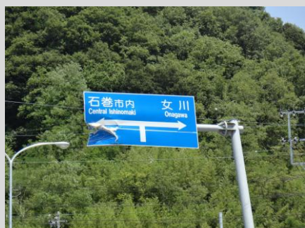
津波による破損と思われる
