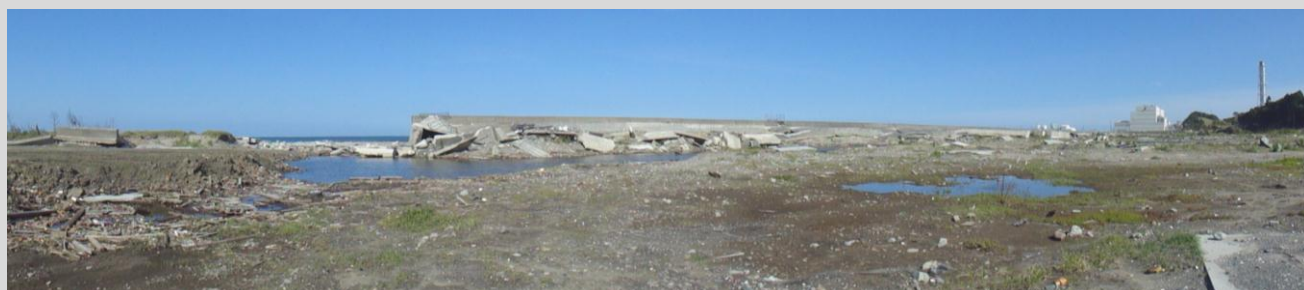
防波堤は崩壊したままである
