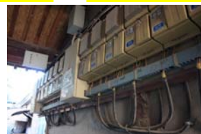
写真-46 電気メーター
